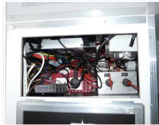
Wechselrichter und Co. sind zentral im Durchstieg zum Fahrerhaus untergebracht
