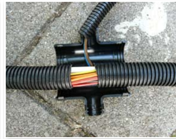
Flexibles Kabelrohr mit verschließbaren Kabelverzweigungen ermöglichen ein sauberes Planen und Verlegen aller notwendigen Kabel
